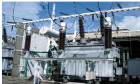
■ Gambar 1. Transformator Daya
