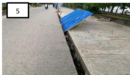
Kondisi Jalan sekitar Polder
