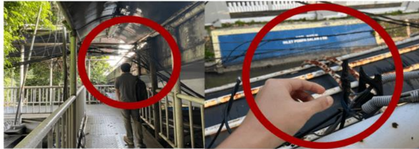
Gambar 13. Dokumentasi kegagalan fungsi railing Sumber: Kodoatie, 2005
