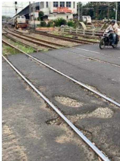
Gambar 7 Perkerasan perlintasan sebidang yang rusak dan berlubang (Pribadi, 2023)
