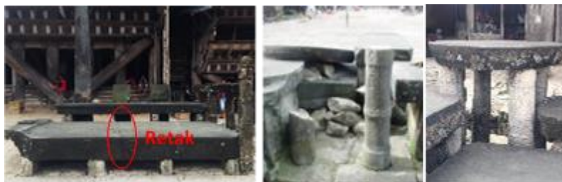
Gambar 7. Batu Megalit di depan Omo Sebua Retak, Hancur dan Mengalami Pelapukan Sumber : Observasi Lapangan dan Hasil Olahan Penulis
