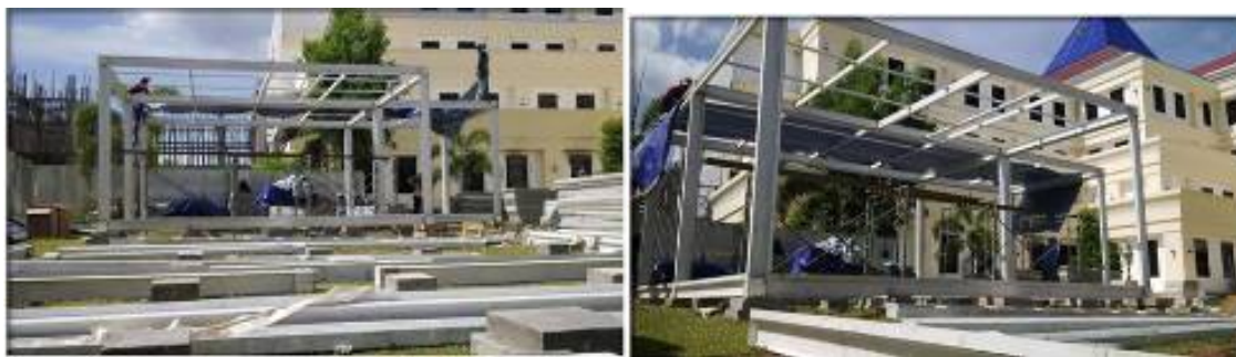
Gambar 7. Aplikasi Bangunan Modular Indostar di Kompleks Kantor Gubernur Maluku
