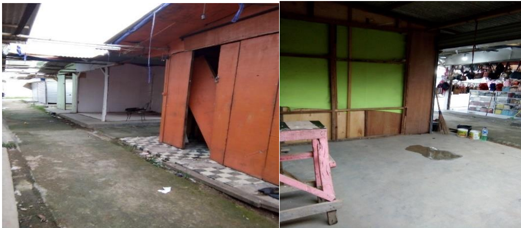
Gambar 1. Kondisi kios di pasar kunciran indah yang rusak, akibat tidak dioperasikan
