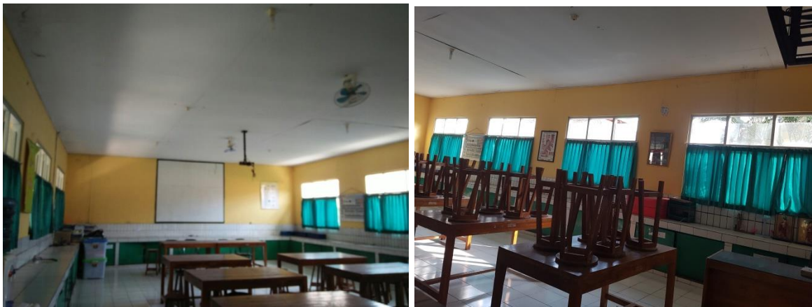
Gambar 6. Kondisi ruang laboratorium IPA sebelum retrofit
