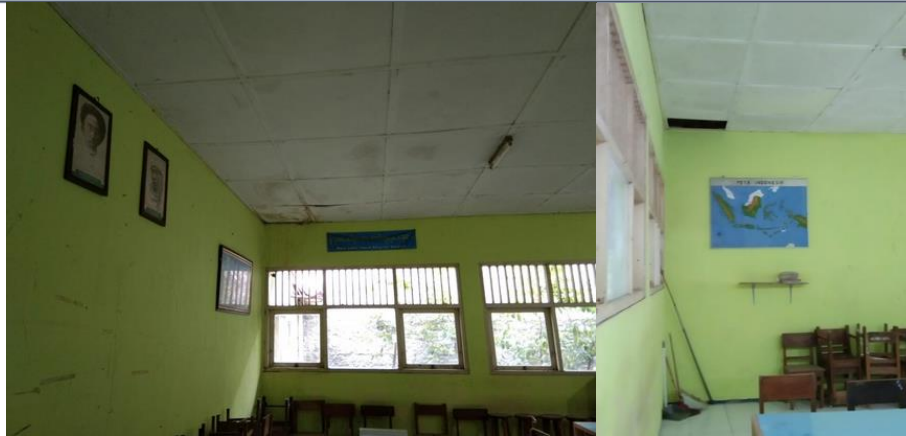
Gambar 2. Kondisi plafon yang bojor dan berlubang pada TPQ Sumber : Penulis, 2022
