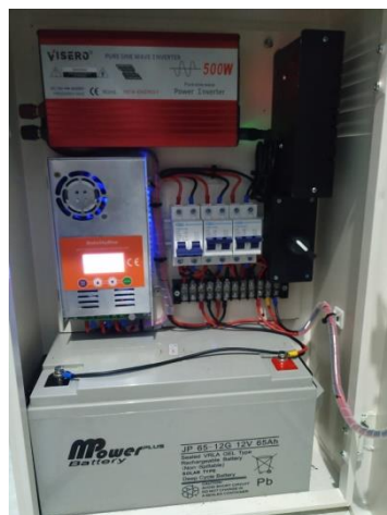
Gambar 9. Panel kontrol tampak dalam
